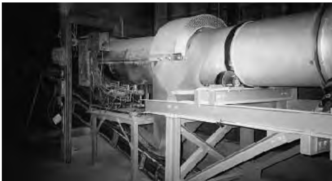
LPガスバーナーとキルン式乾燥機（志津川工場）
